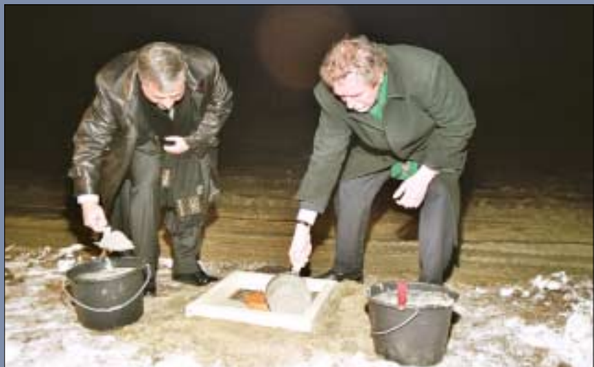
Motti Disser az Aréna Plaza Centers ügyvezető igazgatója és Csécsei Béla polgármester letették az Ügető helyén épülő bevásárlóközpont alapkövét márciusban. A komplexumot várhatóan 2007 őszére adják át
